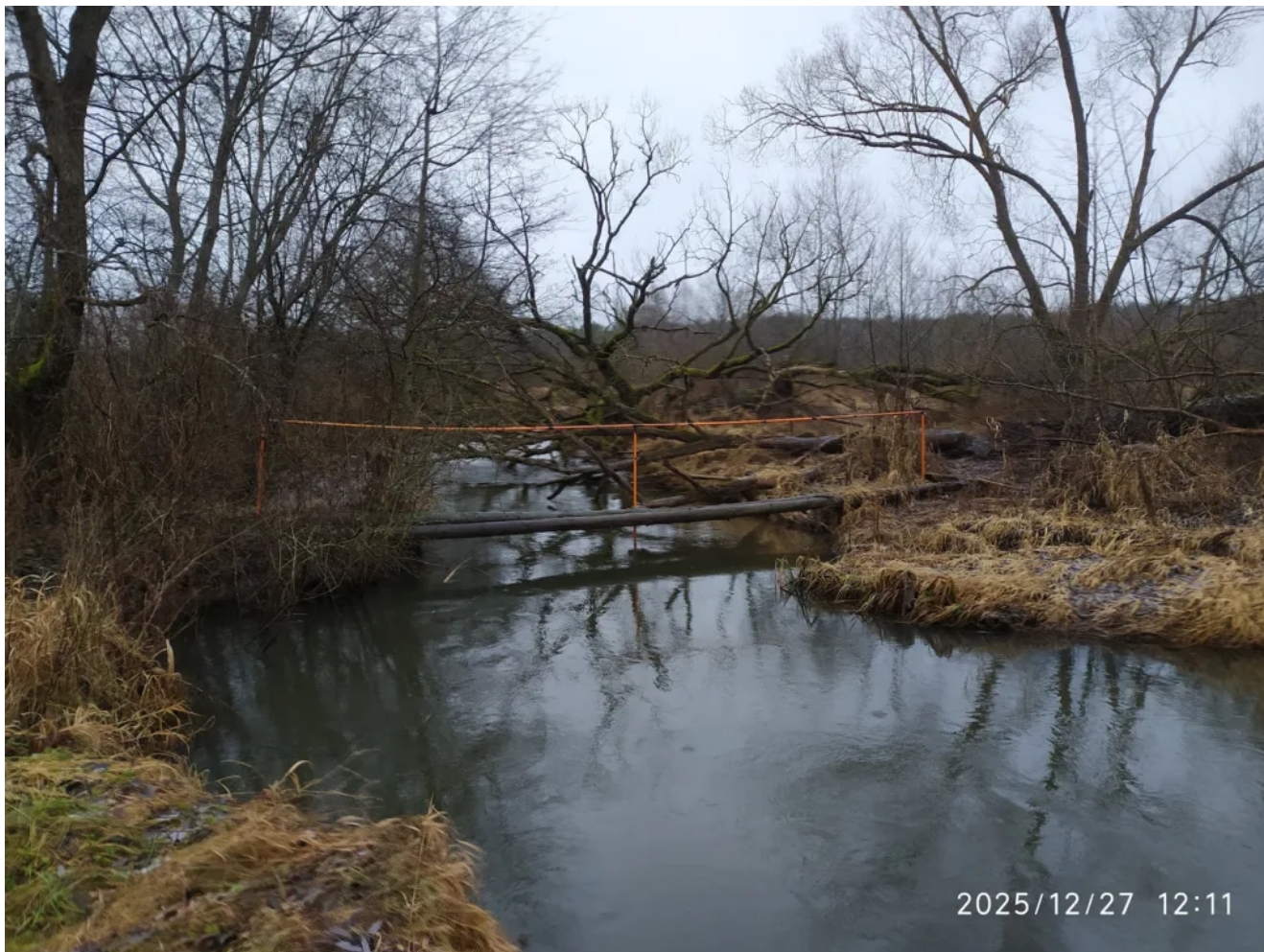
Потерянный участок дороги после моста.
